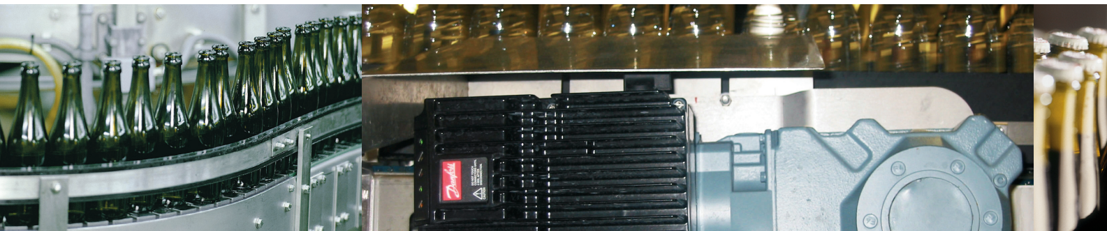
Danfoss Bauer BK-Getriebemotor mit einem auf dem Motor installierten FCD 300 in einer Abfüllanlage für Mineralwasser.
